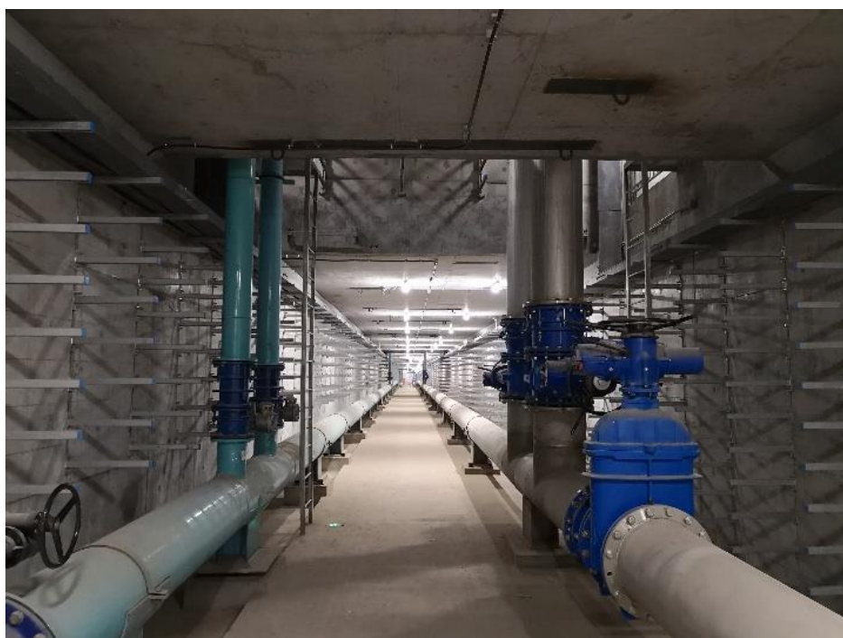
图 5 副中心综合管廊水信舱
