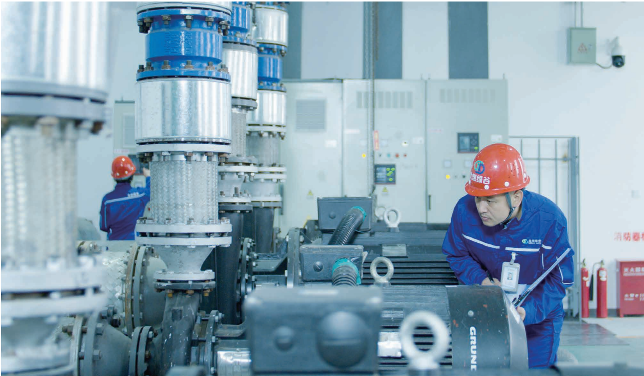
北燃实业供热职工维检修设备
