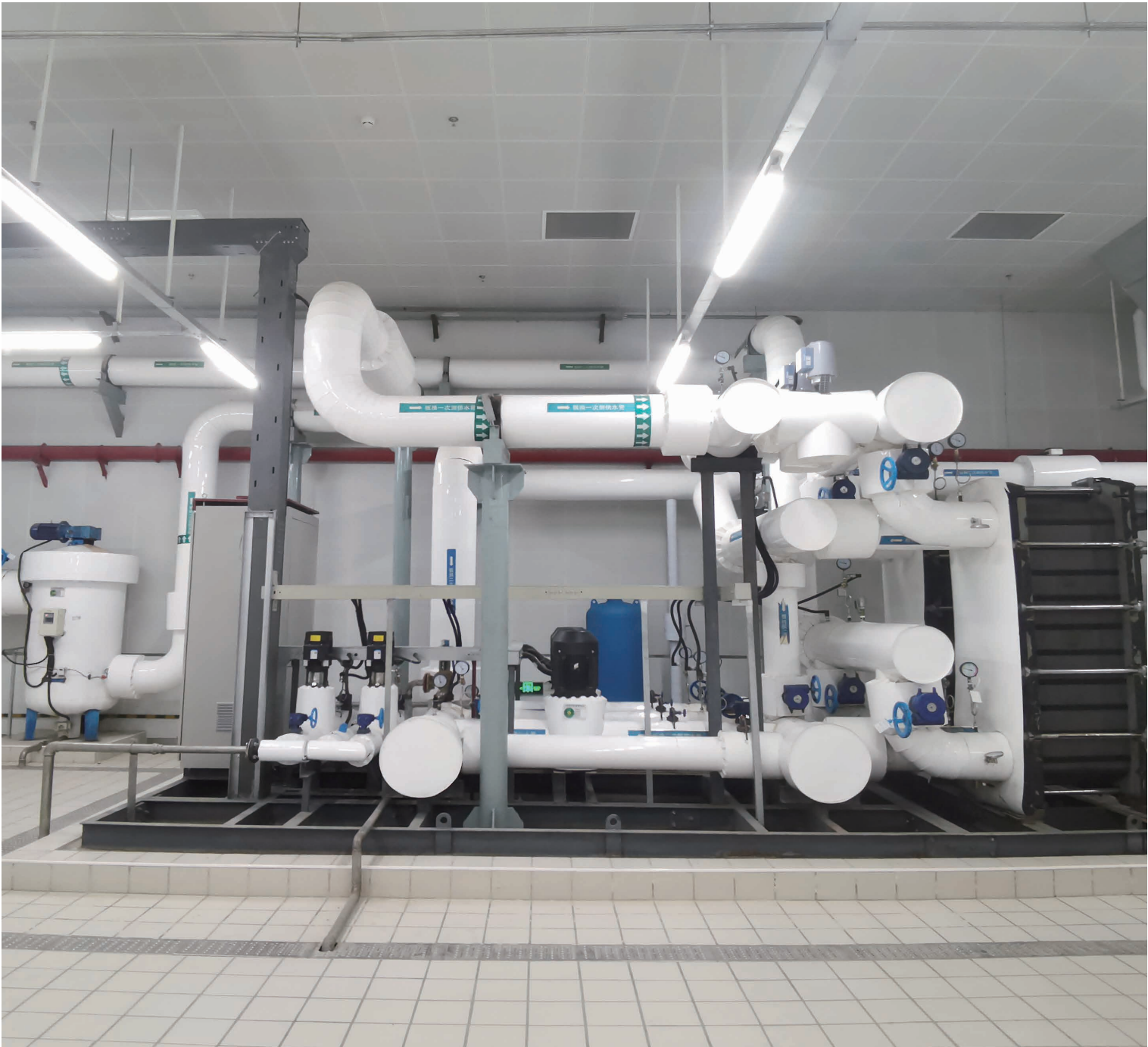
北京城市副中心6#能源站子站
