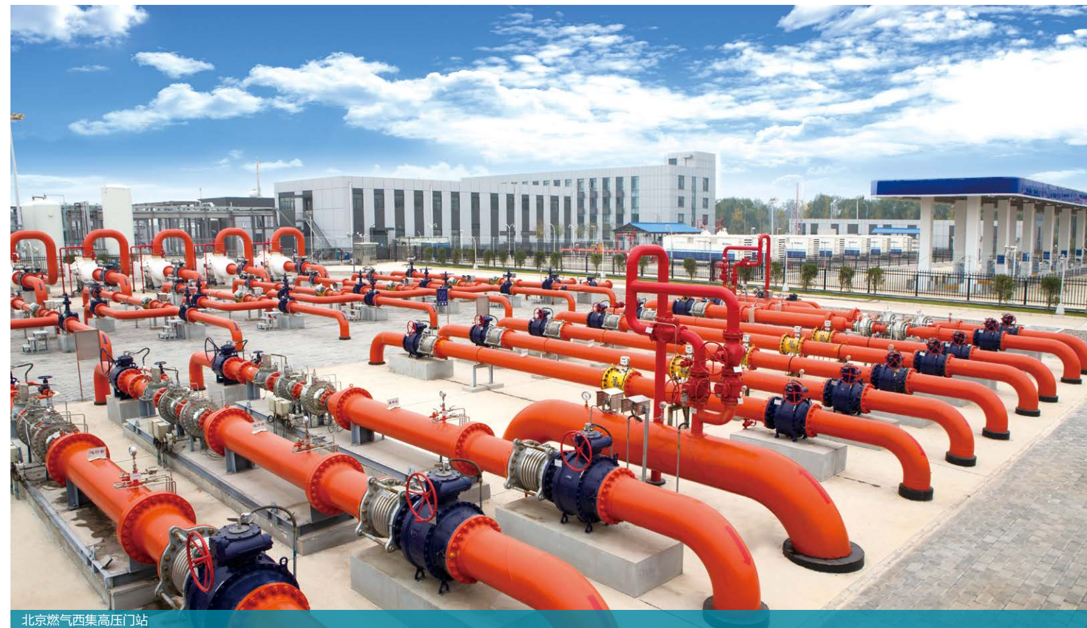
北京燃气西集高压门站
