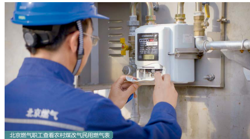
北京燃气职工查看农村煤改气民用燃气表
